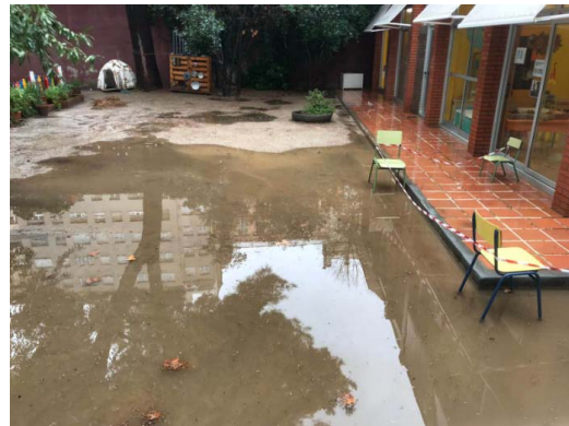
Pati inundat degut a que el drenatge superficial està reblert de sediments (3)
