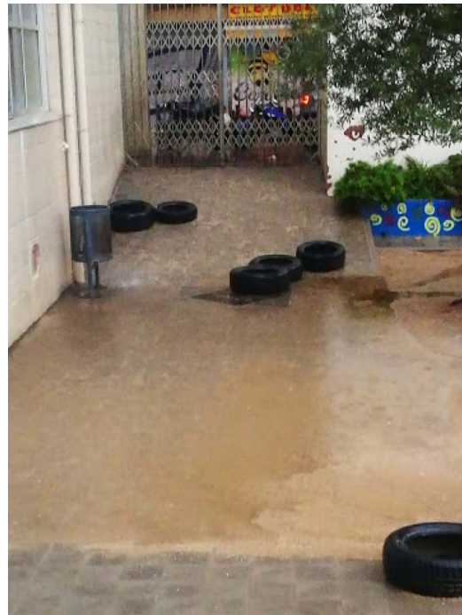
Pati inundat degut a que el drenatge superficial està reblert de sediments (1)
